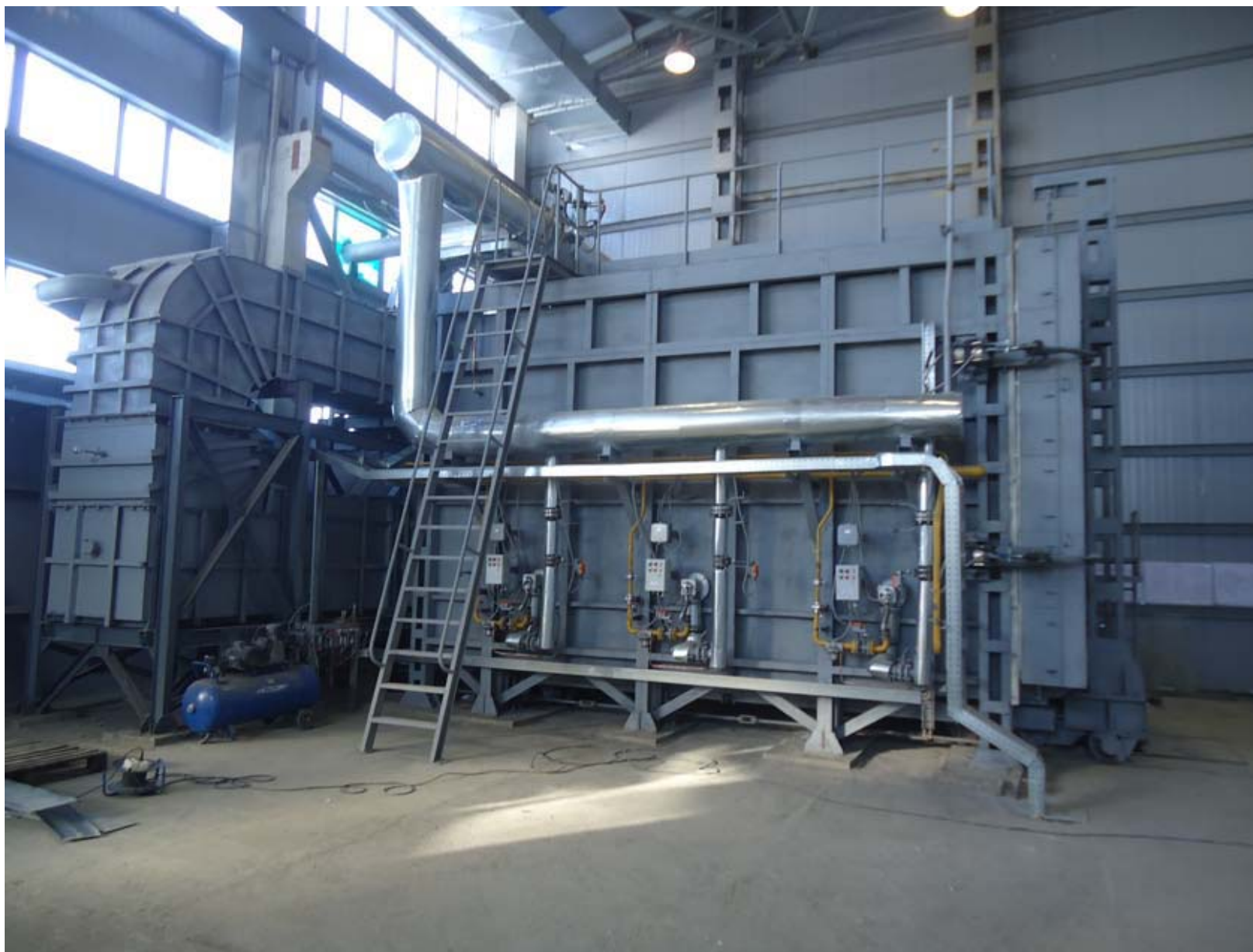
Фото 11. Печь с выкатным подом с камерой дожигания отходящих газов. На печи установлены горелки BIC Kromschroder.
