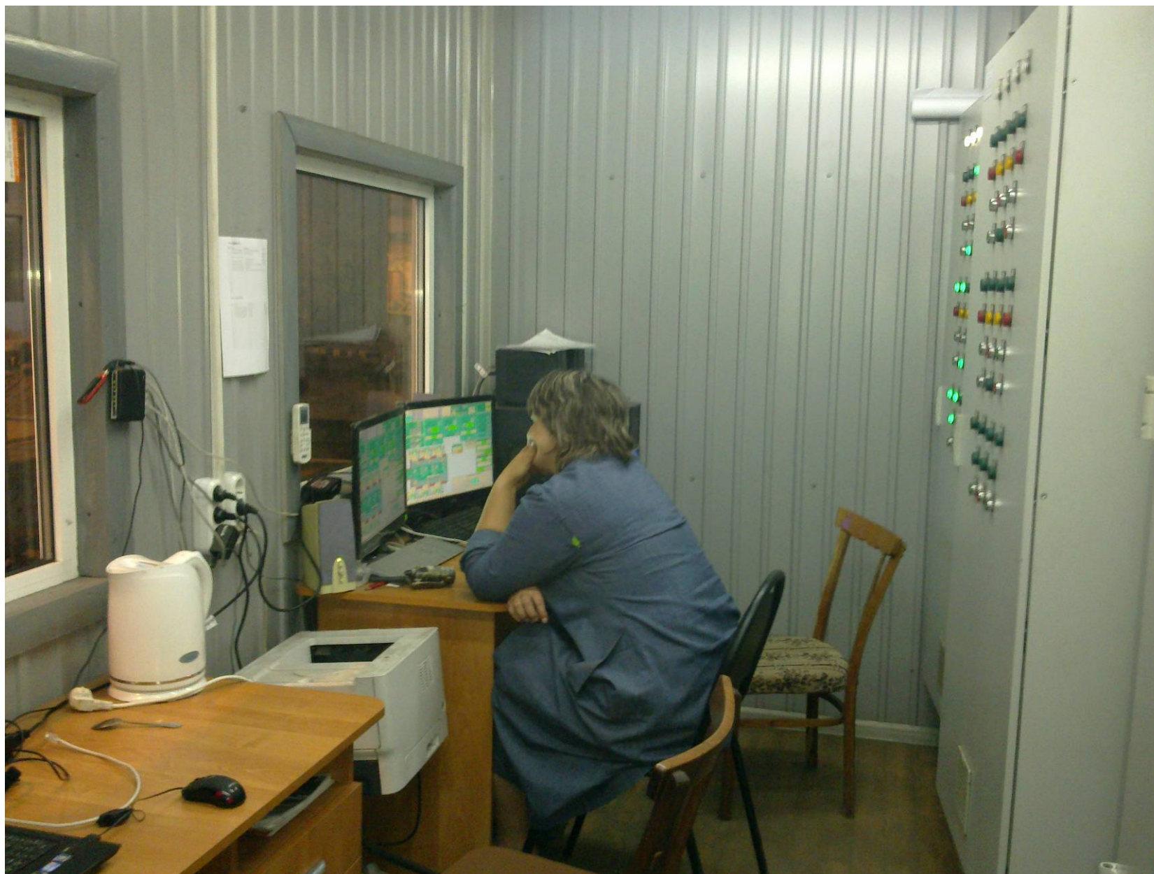
Фото 10. Операторское помещение печи с выкатным подом.
