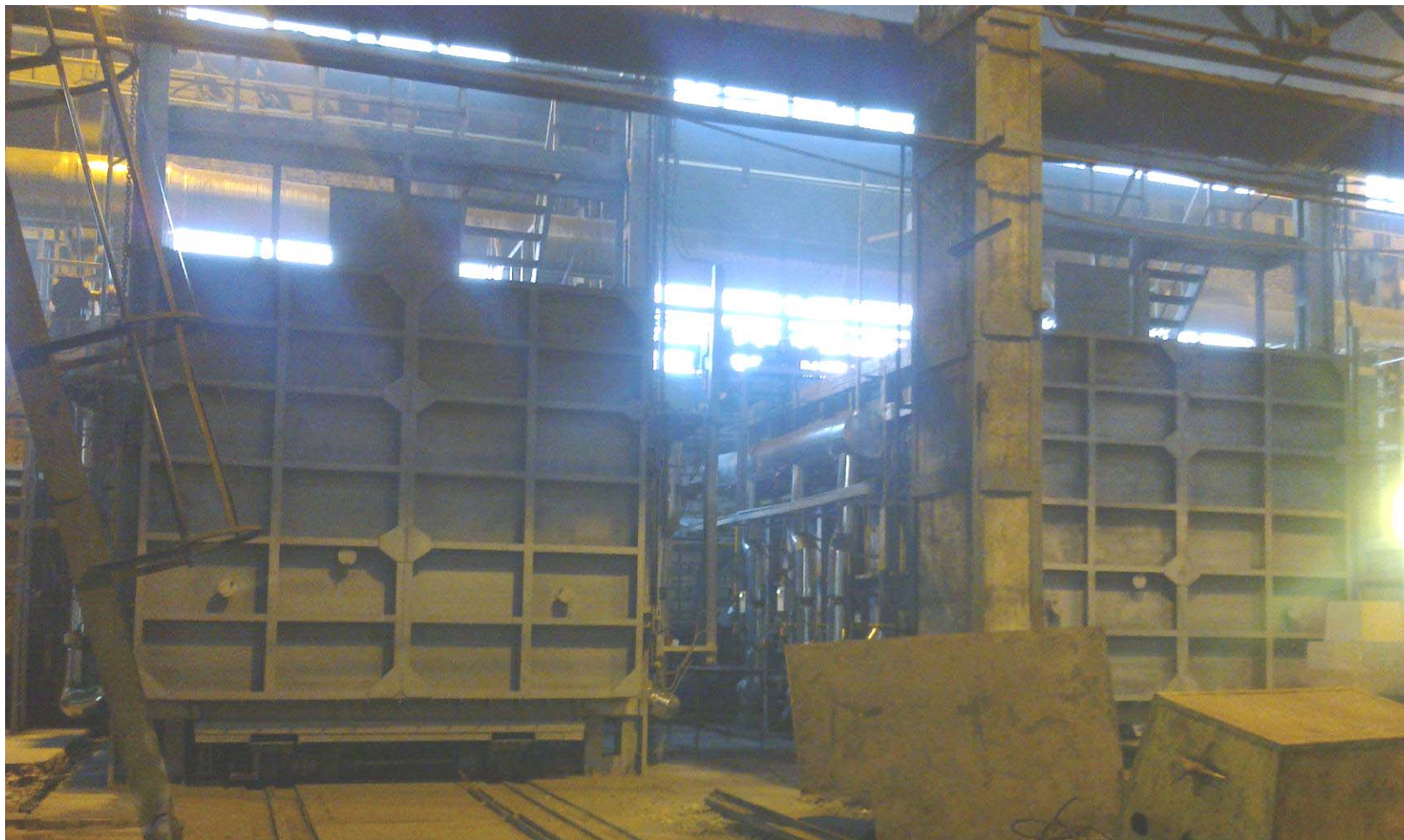
Фото 7. 2 печи с выкатным подом, построенные ООО «АНХ-Инжиниринг» в 2009 г с размером рабочего пространства 6000х3500х2500 мм.
