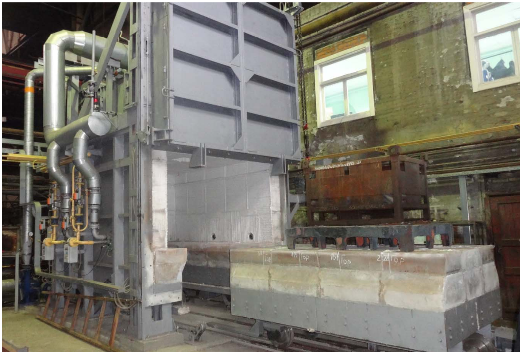
Рис. 6. Печь с выкатным подом для термообработки. ОАО «МЕТРОВАГОНМАШ»
