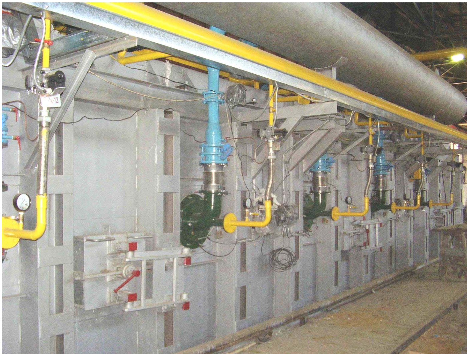
Фото 3. Методическая печь. Установка боковых горелок.
