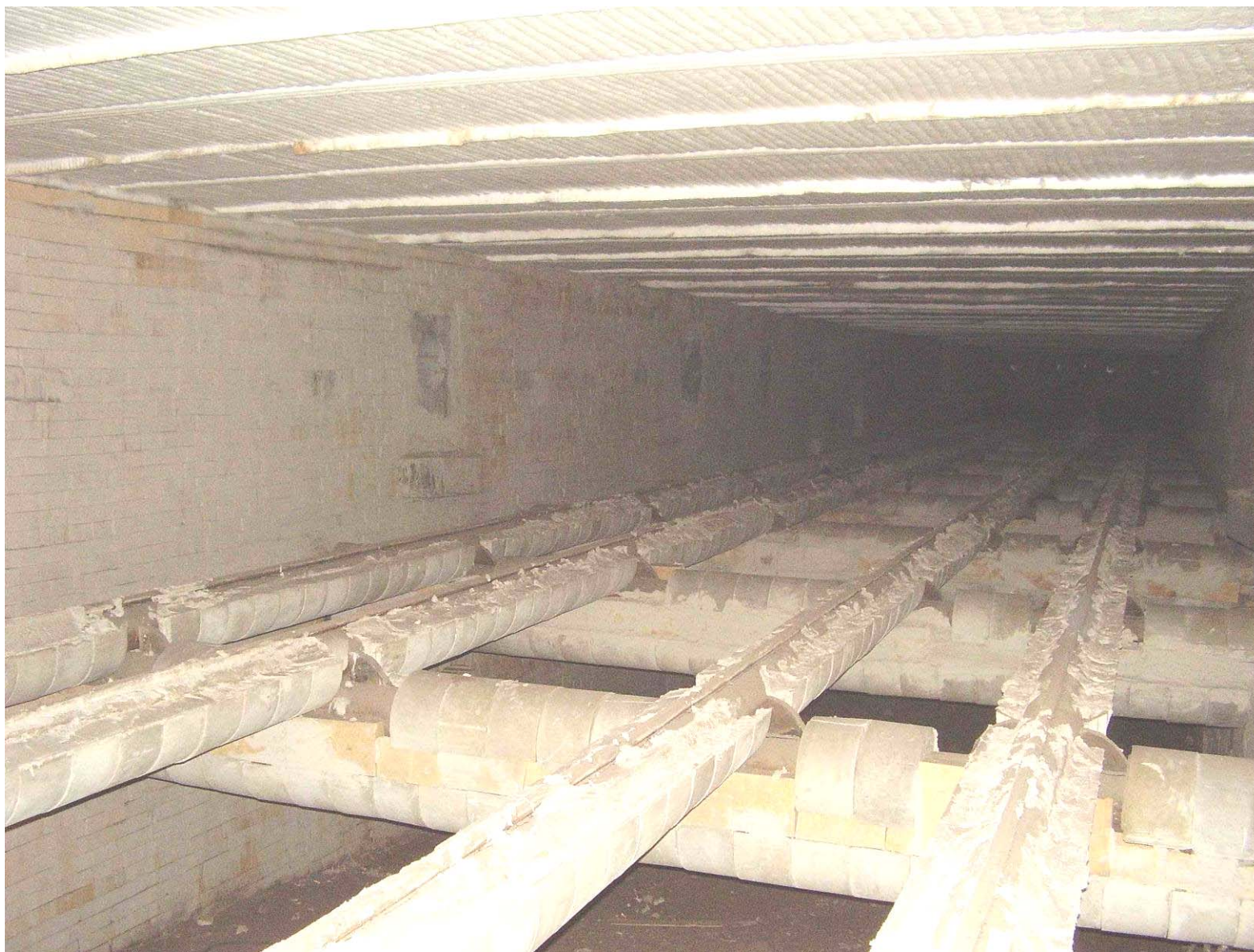
Фото 2. Внутреннее пространство методической печи с панельным волокнистым сводом.
